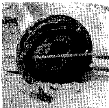
Afzetting in de afvoerleiding
